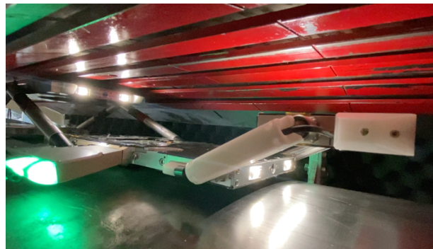
(右図) 発電機モックアップの内部
